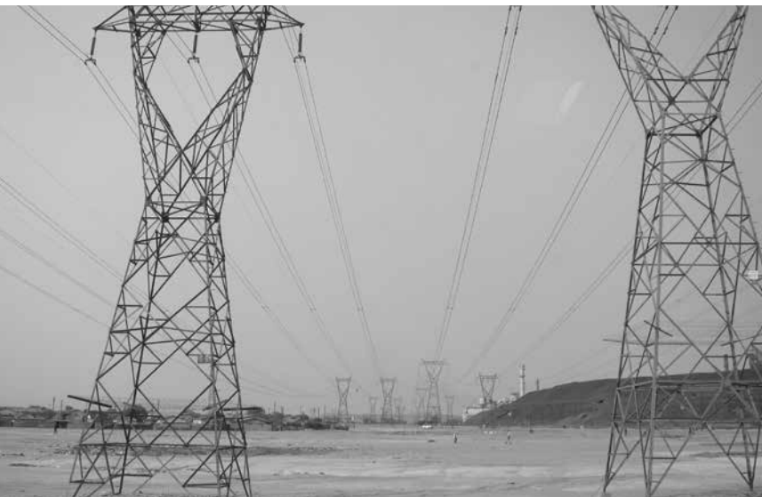
Stromversorgung der Mopani Copper Mines in Mufulira (Bild: Barbara Müller 2017).
